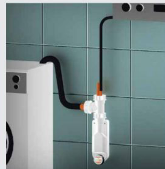
FOTO 4. Esempio di applicazione lavatrici e lavastoviglie + condensa da caldaie, climatizzatori e asciugatrici
